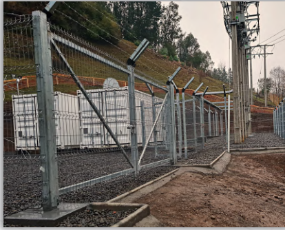
❖ Estación de Baterías de Respaldo. Central Llanccacura. Grupo SAESA.
